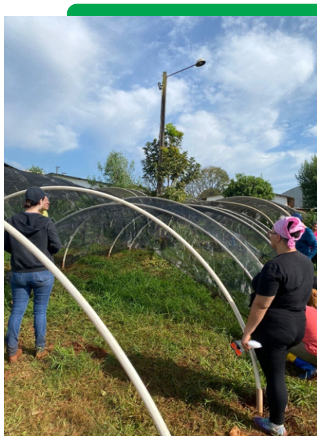
Construção de canteiros para expandir a horta comunitária do CIMMAD e propiciar a realização das oficinas
