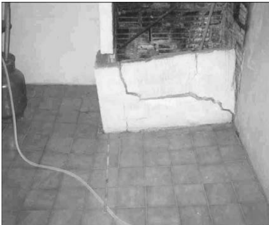
FOTO 6 – Afundamento de parte de casa em função da existência de fossa sob a mesma. Foto: Lia D. Pfluck, em set./2002.
