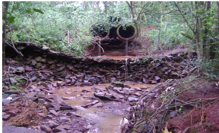
Foto da saída das águas pluviais Bairro Rainha Fonte: Dados da pesquisa, (2009).
